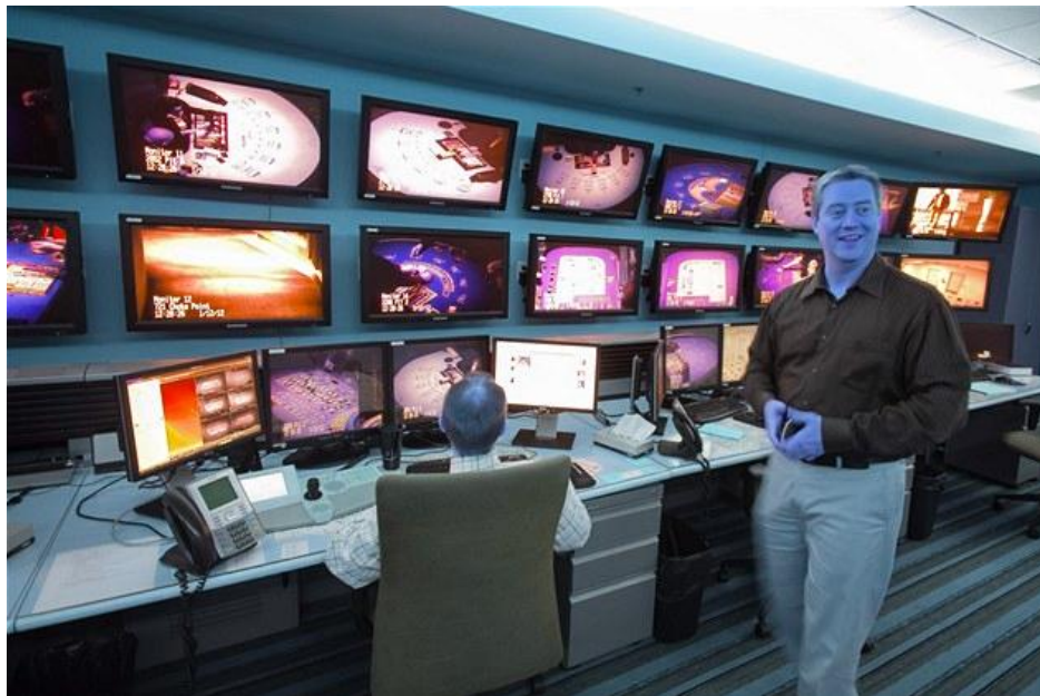
Dohledové centrum (Surveillance Center) v kasinu Aria, Las Vegas
